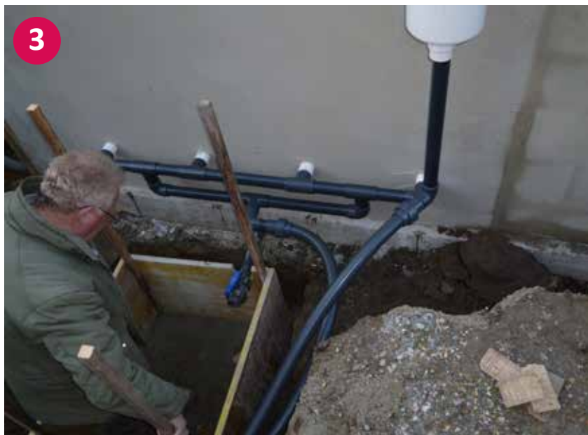
▲ Napeljava šob, skimerja in talnega odtoka
